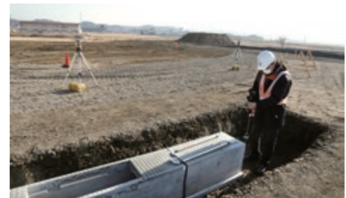
構造物計測・設置 床掘りは杭ナビショベルで、U字溝・L字溝の設置は杭ナビで！
